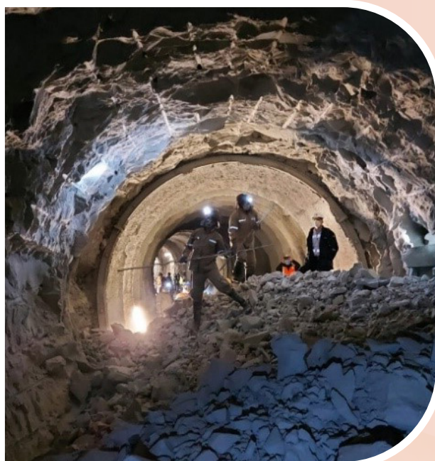
En fecha 18 de octubre se ejecuta empalme entre los frentes F7 y F8 – Túnel Juntas
