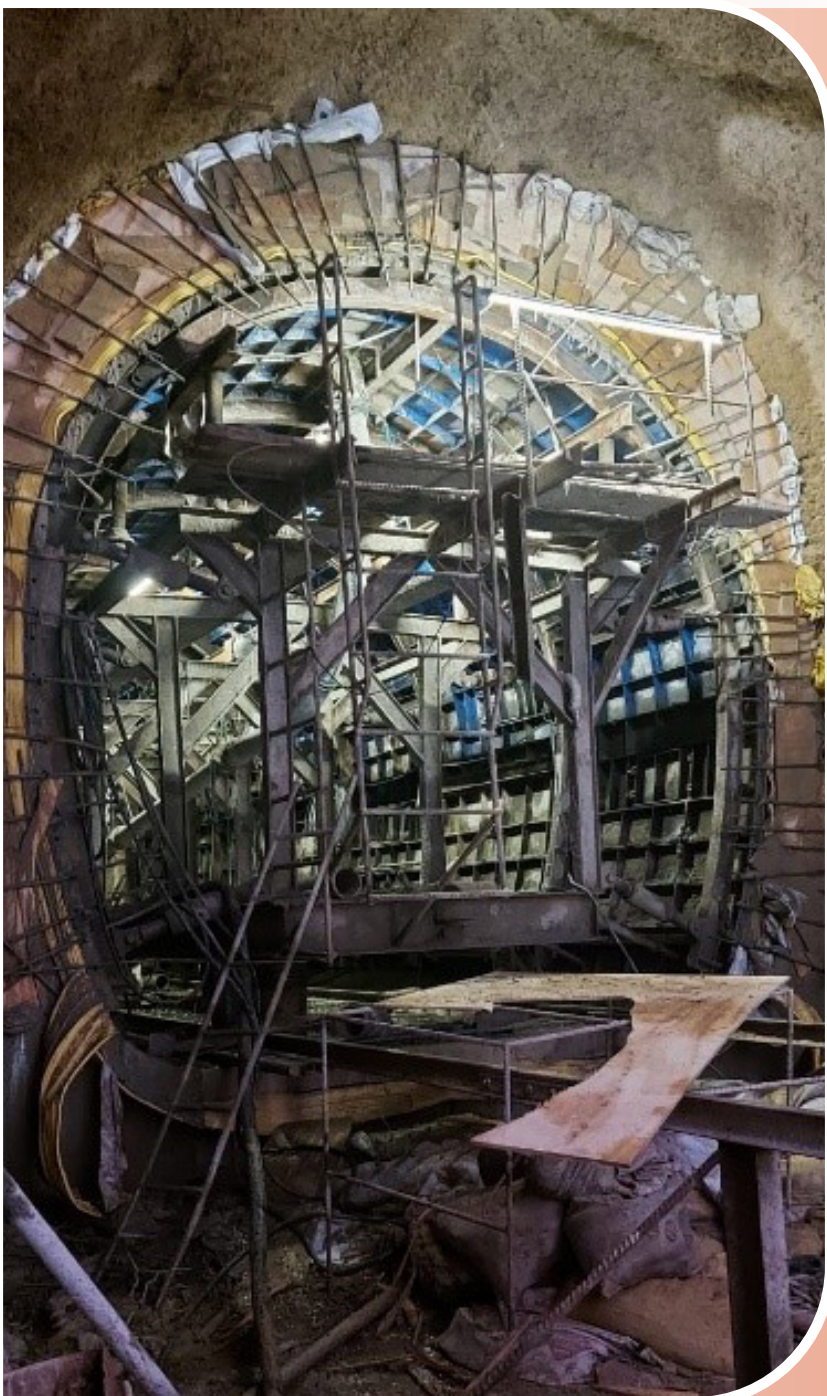
Hormigonado de tramo de intersección pozo y túnel – Obra de toma Sehuencas
